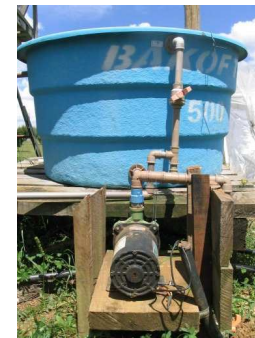
Figura 11: Detalhe da motobomba ligada ao reservatório. Foto: Bortolozzo (2006)
